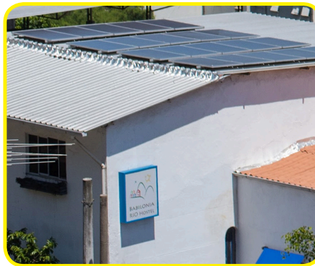
2- Babilônia Rio Hostel (5 kWp)
